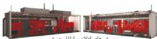
سیستم های اعلان و اطفاء حریق هیدراتت، فوم، CO2
